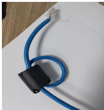
图二：网线插口处增加磁环，靠近网口处，如图缠绕 1-2 圈；
